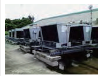
室外機外観写真
