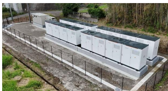
兵庫県姫路市蓄電所
