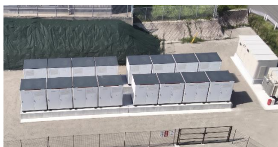
佐賀県みやき町蓄電所
