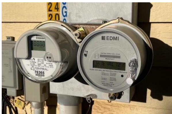
実際に家庭に設置された EDM I スマートメーター
