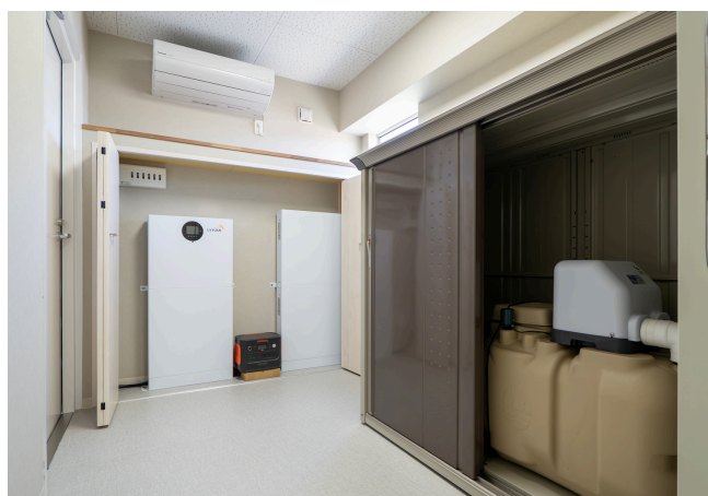
蓄電池と給水設備
