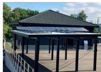
太陽光発電設備
