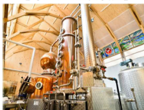
【導入した蒸留装置】
