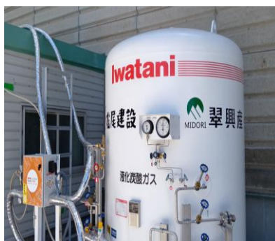
液化CO 2 貯蔵タンク
