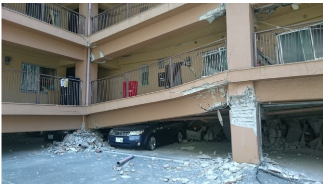
平成 28 年 熊本地震 マンションの 1 階
