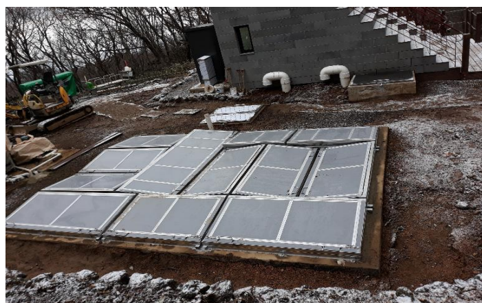
水土浄化装置（土壌処理槽）
