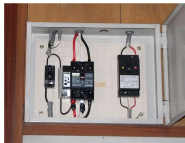
感震ブレーカー設置状態
