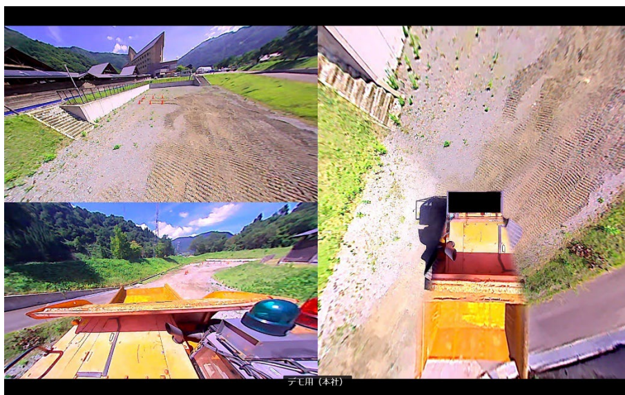
遠隔操作中の画面。全方位映像(右)で重機の周囲を確認することができる
