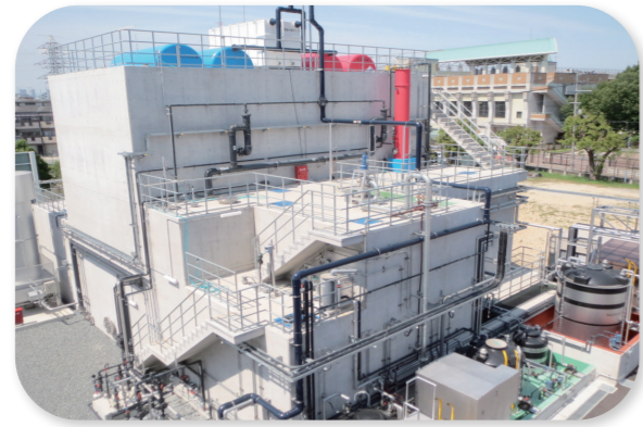
甘水エコロジープラント (UASBシステム) の外観
