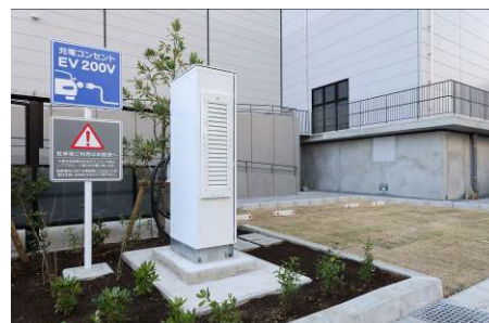
【EV充電ステーション】
